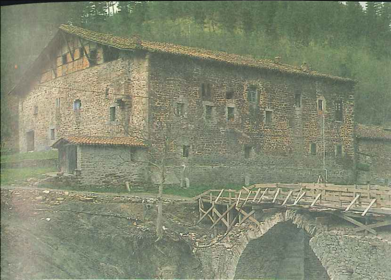
OLABARRI. Orozco, Vizcaya. Casa cabo de armería. En su puente particular de acceso se aprecian los efectos de las trágicas inundaciones de Agosto de 1983.
